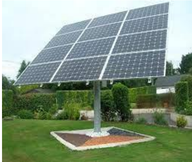
Figure 2.4 : Suiveur en panneaux solaire [17]
