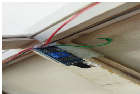
Figure (IV.12) : Fixation de supporte des capteurs de position.
