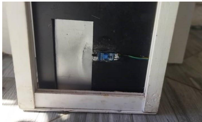
Figure (IV.16) : fixation de photo cellule.
