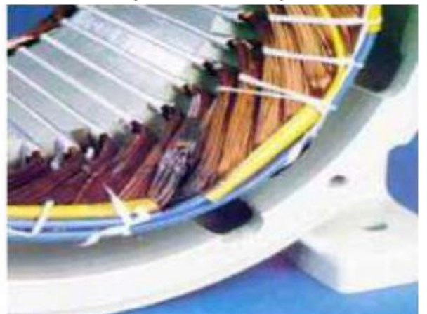
(f) : Dégradation causée par une surtension
