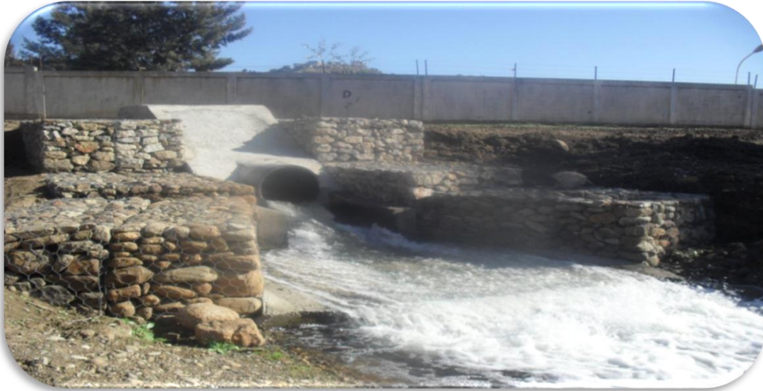
Figure 18 : La sortie de l'eau épurée vers l'oued
