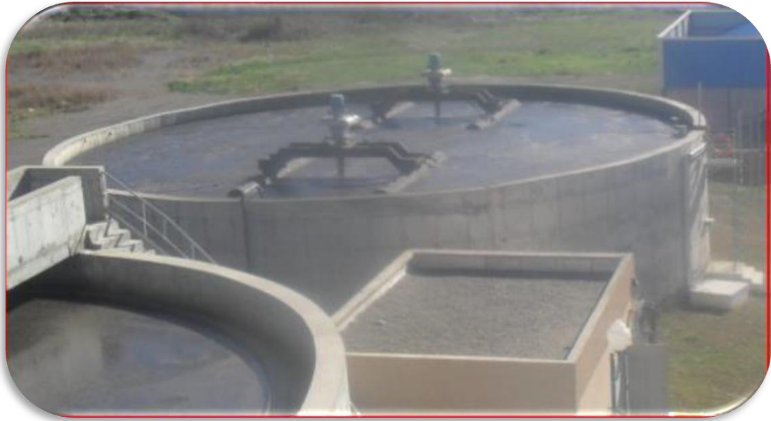
Figure 20 : La Stabilisation aérobie des boues
