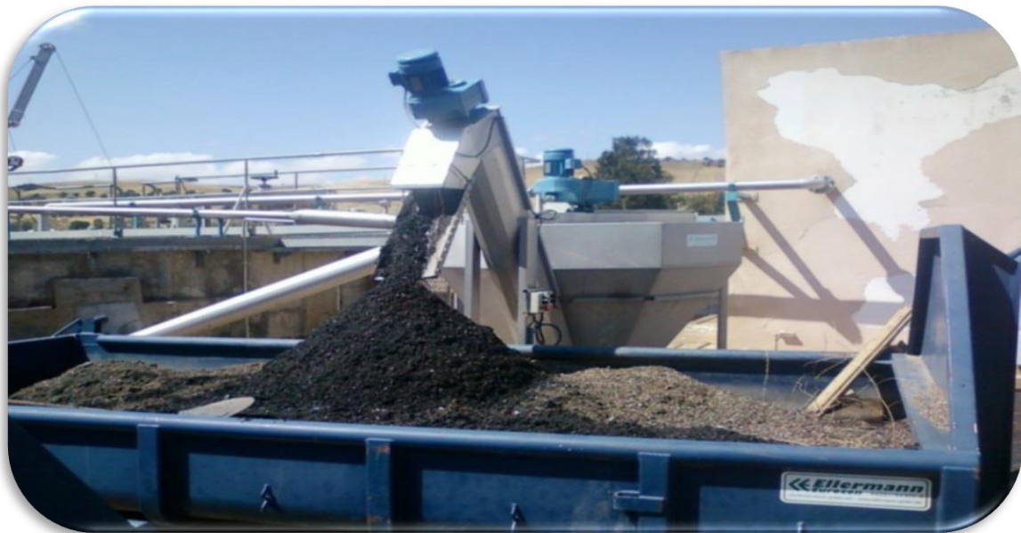
Figure 12 : Traitement des sables
