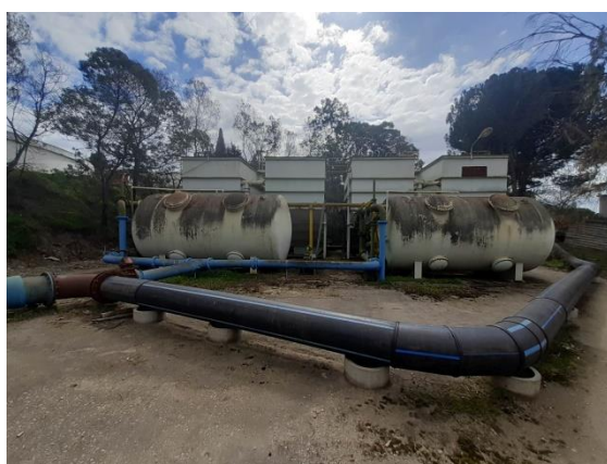
Figure 8: Conduite de refoulement
