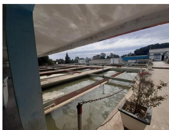
Figure 9: Traitement de l'eau
