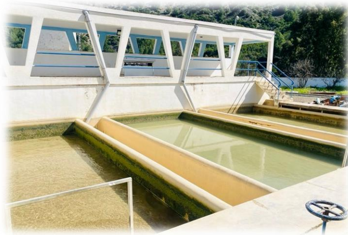
Figure II. 8: Filtres à sable
