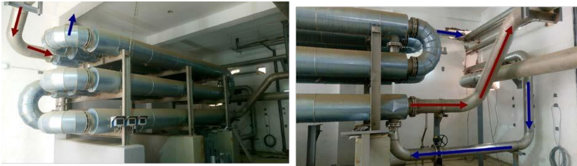
Figure II.11 : Echangeur de chaleur de la STEP de BARAKI.
