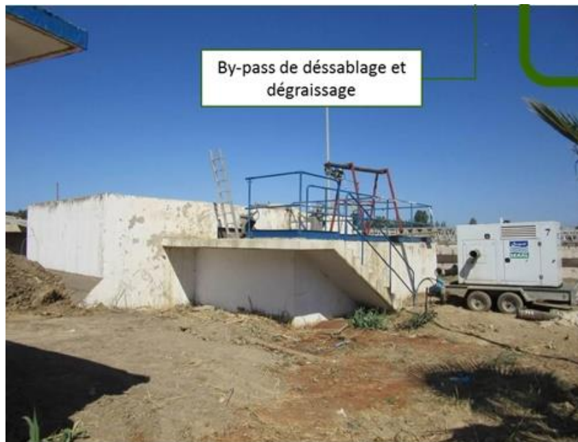
Figure V.5: Bassin de répartition et de by-pass du traitement biologique.
