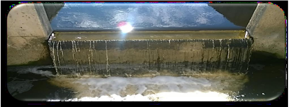
Figure 17: Le bassin de chloration (la sortie des eaux épuré)
