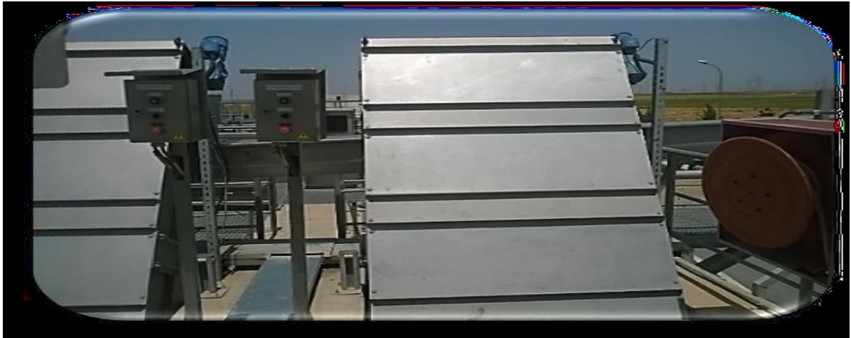
Figure 10 : Le Dégrillage fin.
