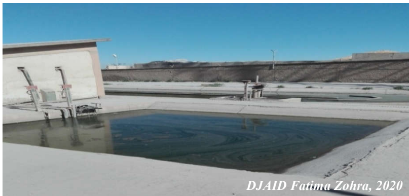
Photo 18: Bassin de compensation.
