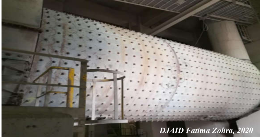
Photo 02 : Broyeur des matières premières.
