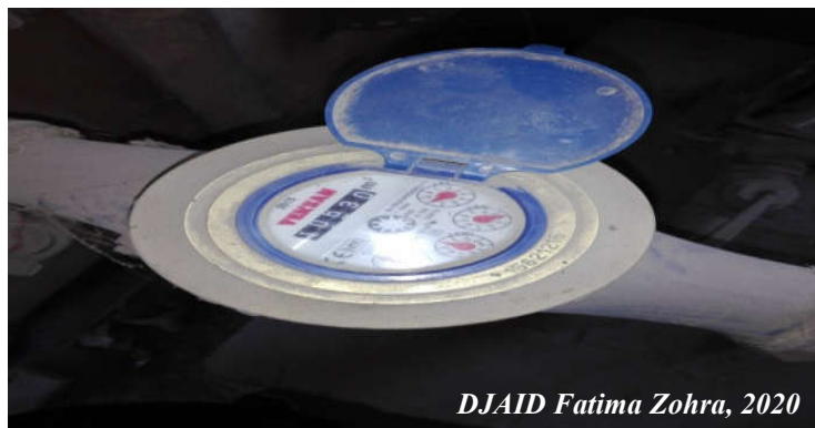
Photo 20: Compteur de la valorisation d'eau.
