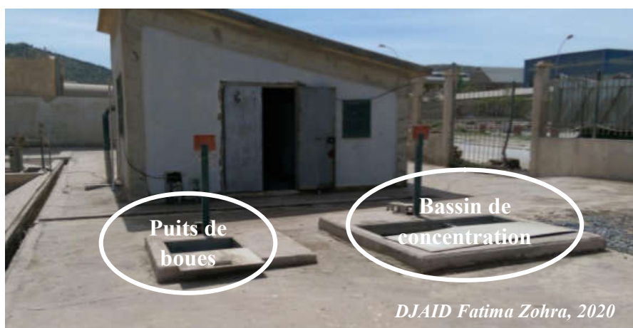
Photo 21: Le puits des boues et le bassin de concentration.
