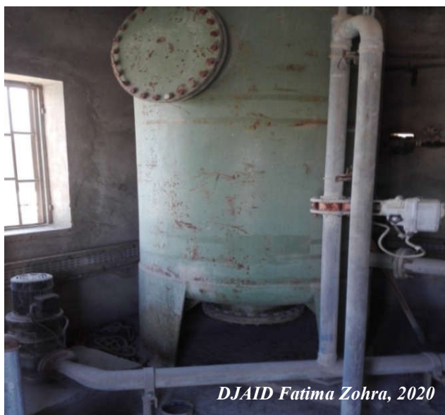
Photo 19: Filtre à sable.
