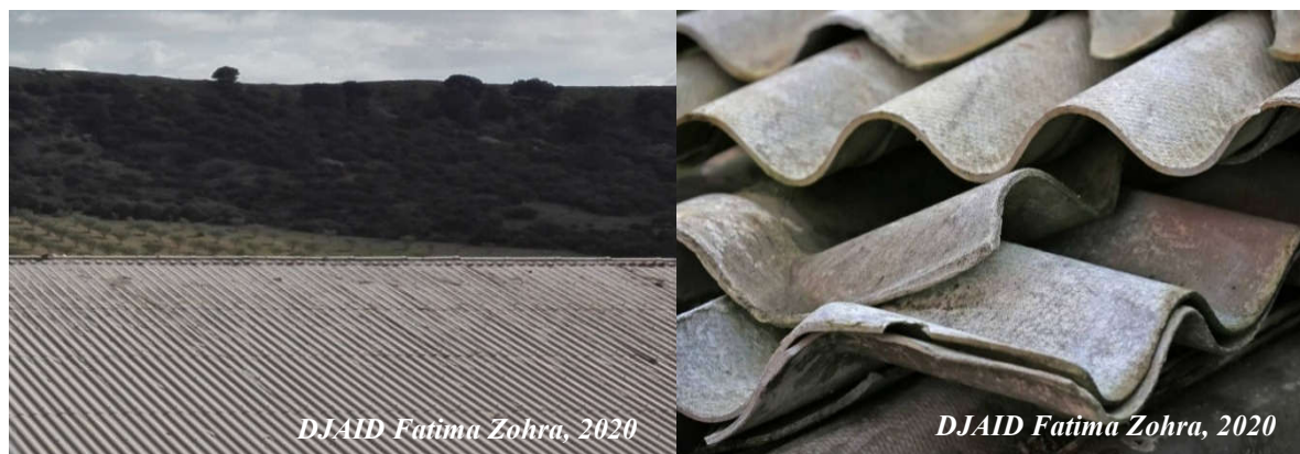
Photo 13: Tuiles d'amiante de la cimenterie de Sour El Ghozlane.
