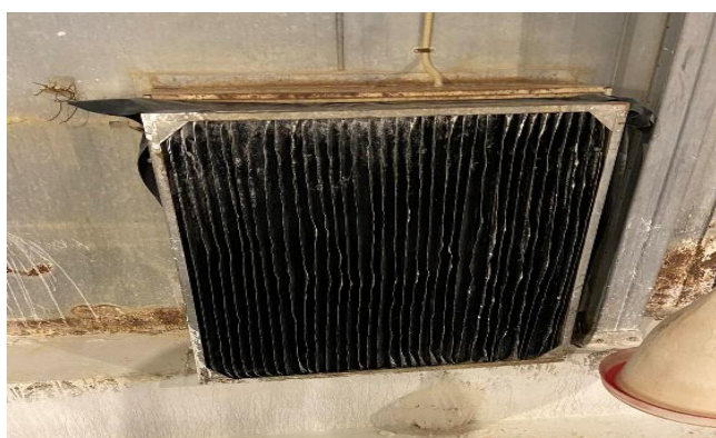
Figure 10: extracteurs du bâtiment
