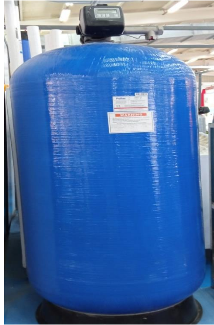
Figure III. 2: Filtre sous pression prise le 17/05/2023.
