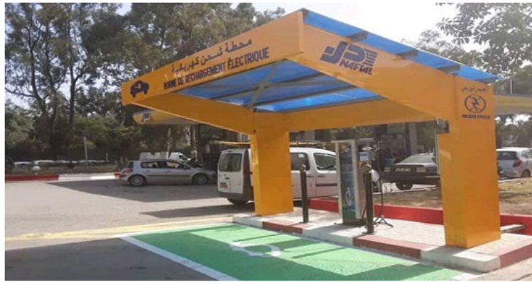
Figure 1.3 : Point de rechargement électrique.
