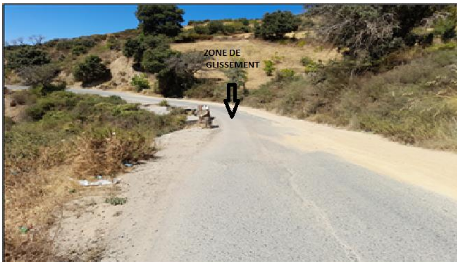
Figure II. 1: Situation de zone de glissement de profile 01.
