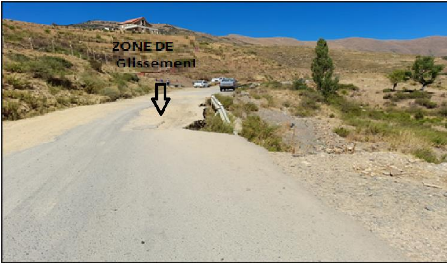
Figure II. 2: Situation de zone de glissement de profile 02.
