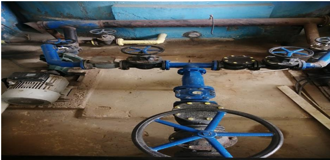
Figure III.9: L'intérieur de la Station de pompage SRF8
