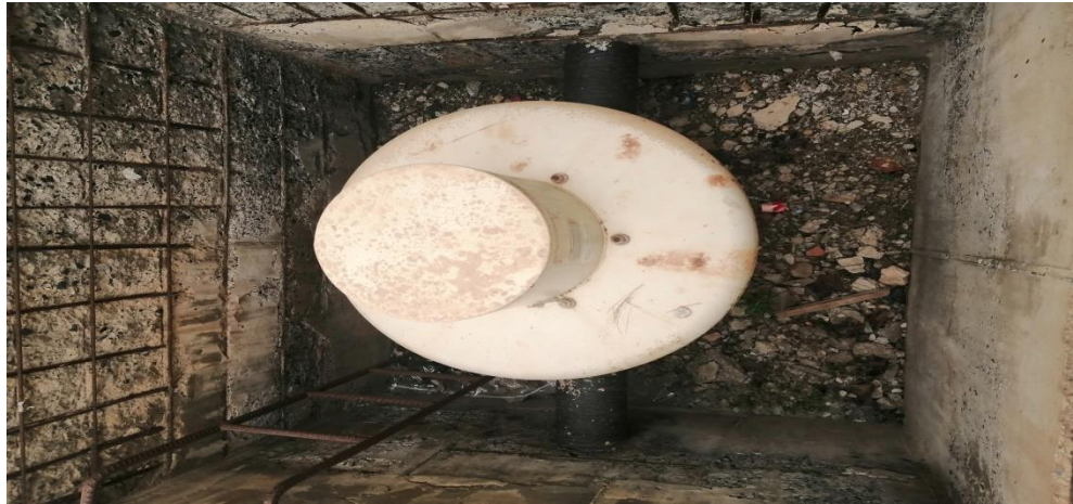
Figure III.10: La ventouse ne fonctionnent pas et mauvaise
