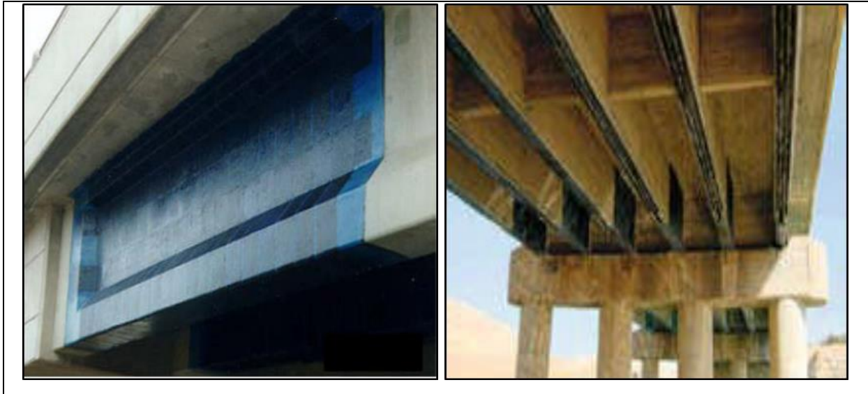
Figure II.12. Poutre de pont en béton renforcée par feuilles de PRF de carbone collées extérieurement [38]
