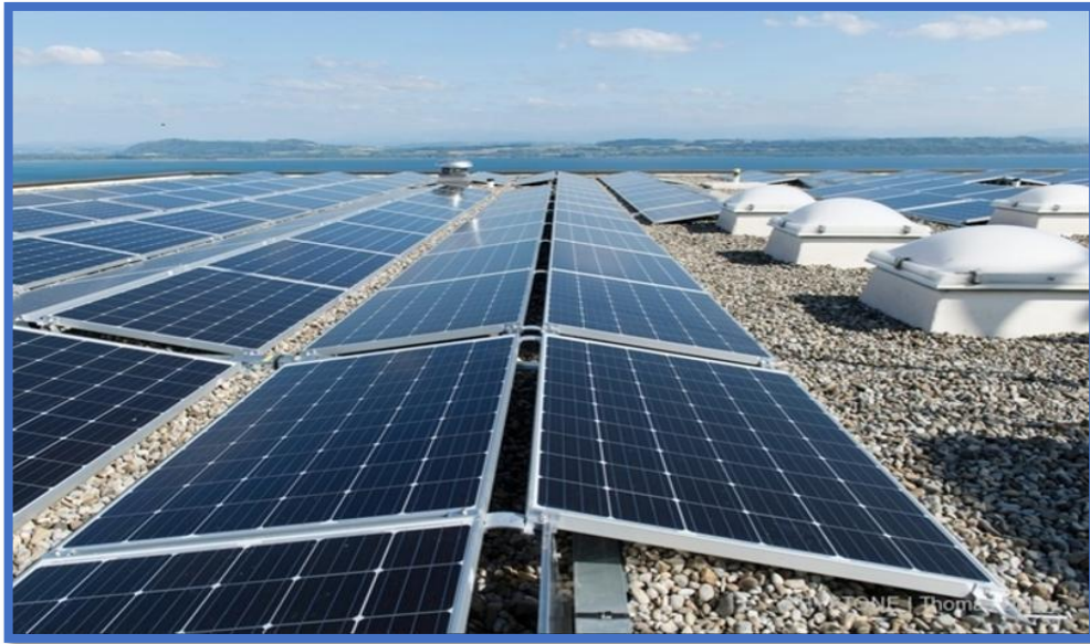
Figure I.5 : Les panneaux solaires [7]
