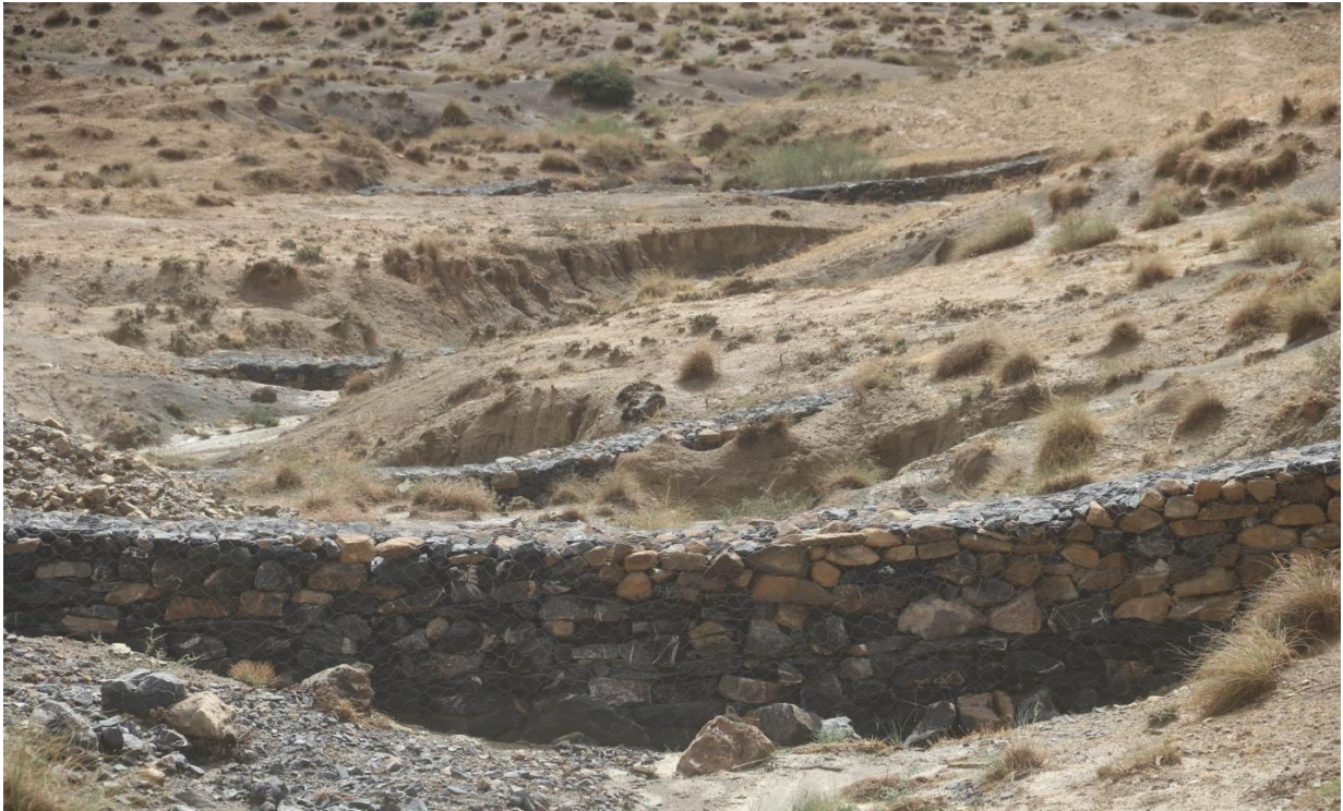
Figure 14 : La fixation mécanique effectuée par l'ERGR dans la zone d'Oued el Maleh en 2021.
