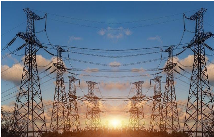
Figure I. 2 Les lignes électriques
