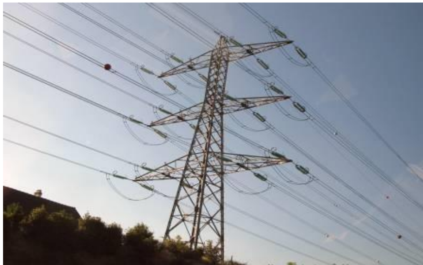
Figure I. 8 Photo d'une ligne haute tension
