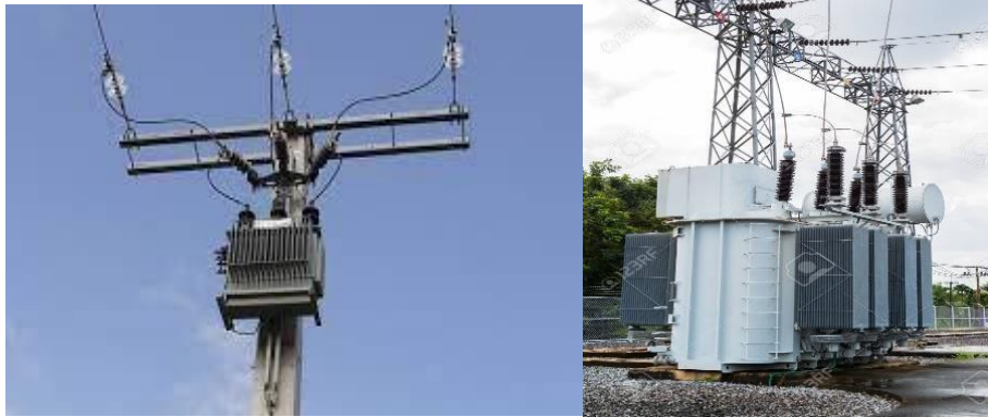
Figure I. 3 Les postes de transformation
