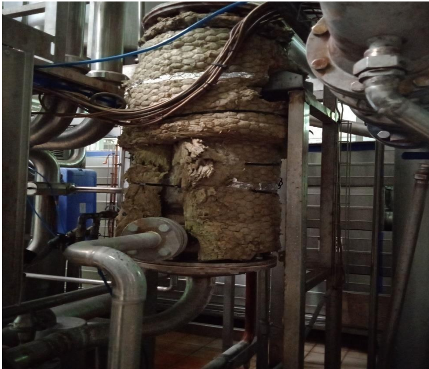
Figure I.6: Échangeur de chaleur tubulaire Eau/Vapeur
