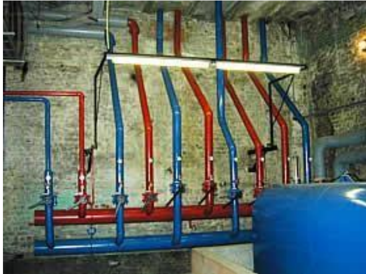
Figure 1-6 : un exemple de tuyauterie utilisé dans une installation de chauffage central a gaz.
