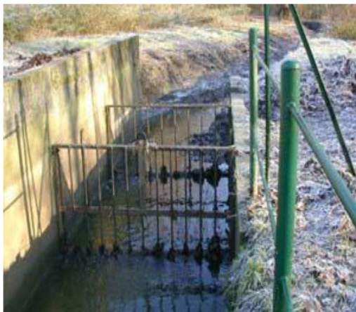
Dégrilleur destiné à retenir les objets Flottants avant l'entrée d'un étang
