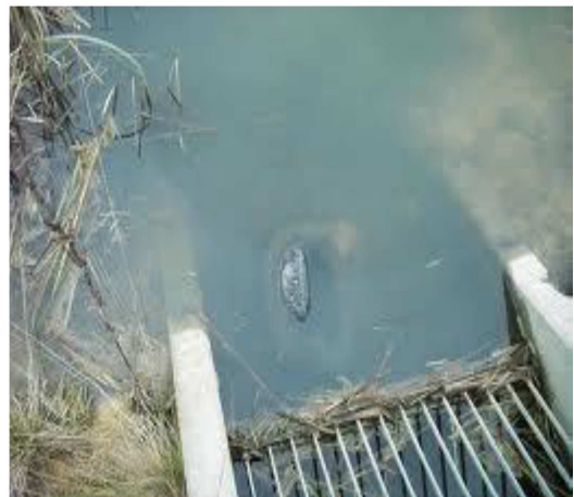
Exemple de flottants retenus par un dégrilleur
