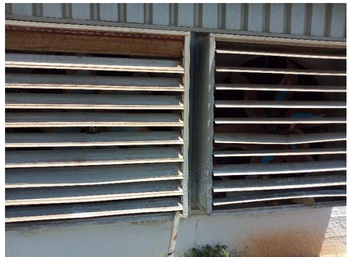
Figure 18 : Ventilateur (Photo personnelle,
