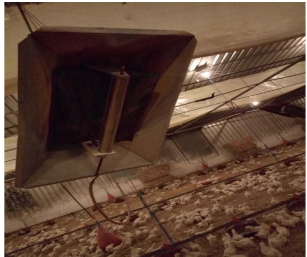
Figure 16 : Chauffages (Photo personnelle, 2021).
