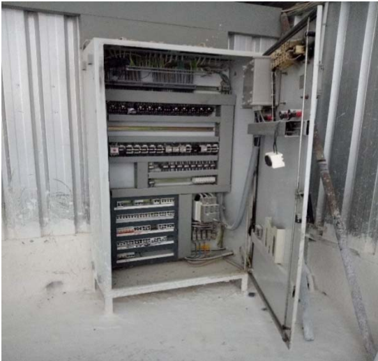
Figure 15 : Armoire de commande (Photo personnelle, 2021).
