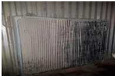
Figure 4 : Vue d'intérieure d'extracteur du bâtiment (Messili N, 2018).
