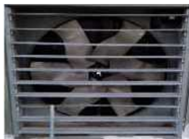
Figure 5 : Vue d'extérieure d'extracteur du bâtiment (Messili , 2018)
