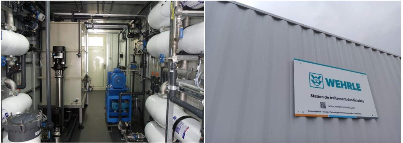
Figure 20 : L'intérieur et l'extérieur de la station du traitement du lixiviat (AMENHYD, 2020)
