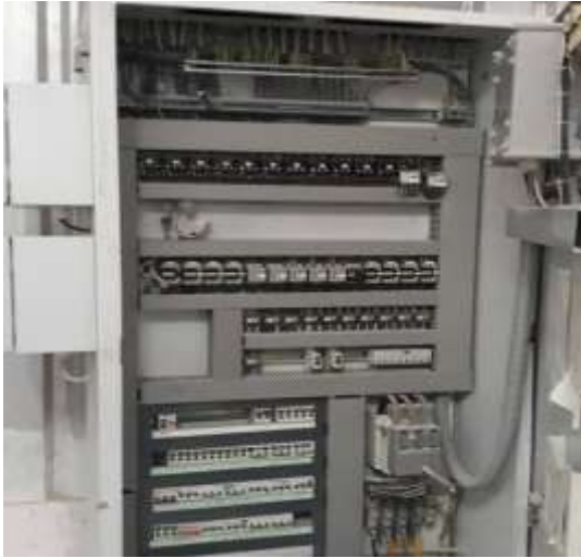
Figure 14 : Armoire de commande,
