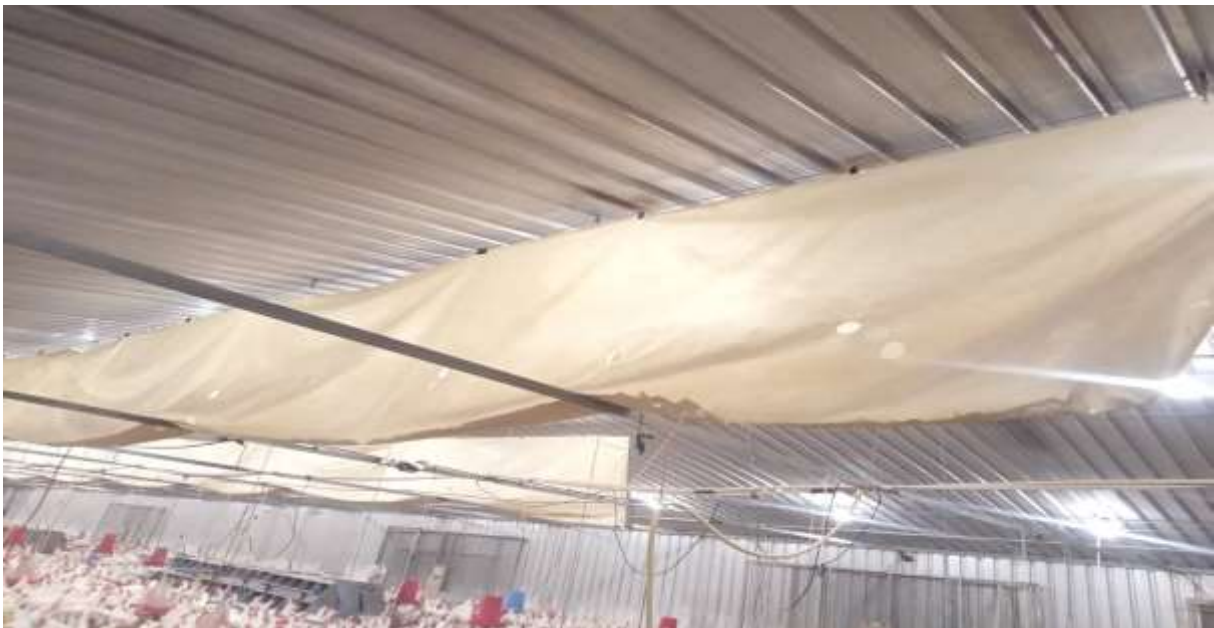
Figure 17 : système de refroidissement fan jet (photo personnelle)
