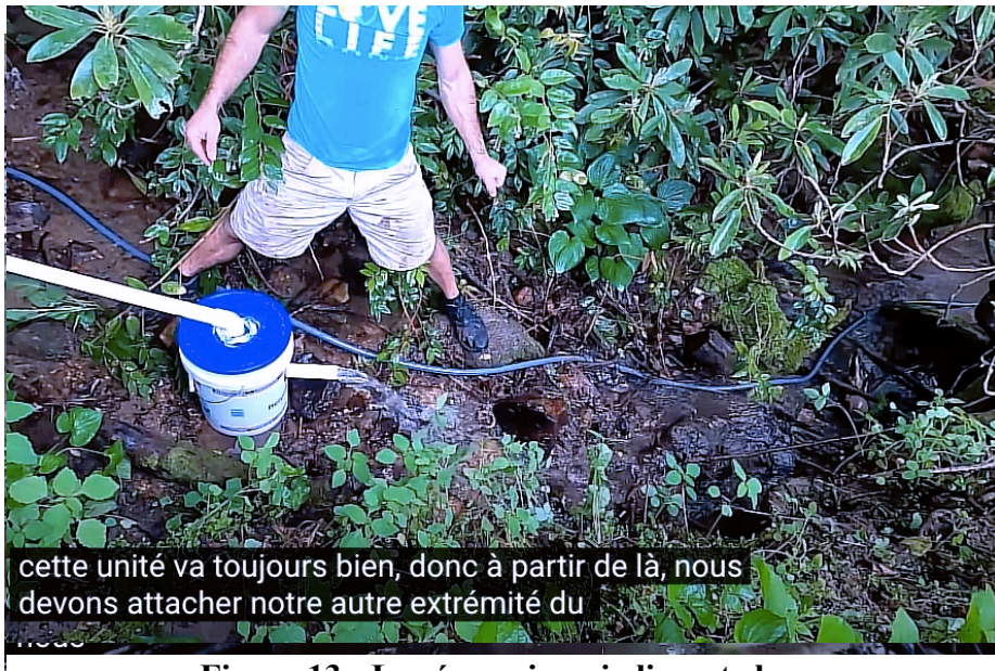
Figure 13 : Le réservoir qui alimente la pompe
