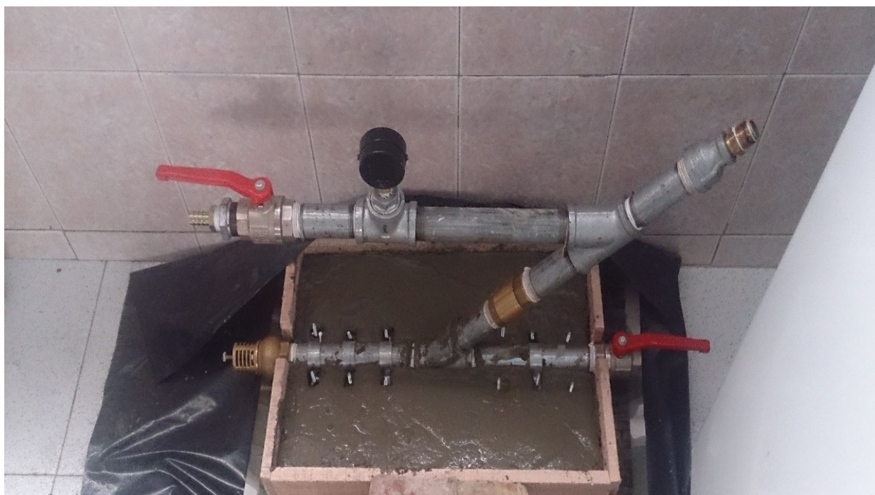
Figure 25 : Base du bélier en béton
