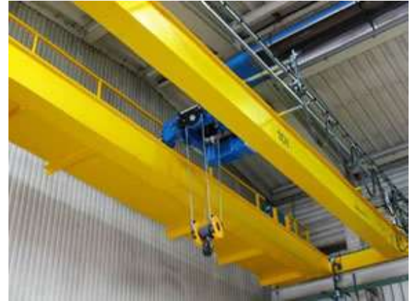
b) Ponts roulants posés bipoutres
