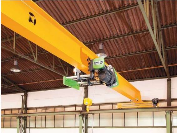
a) Ponts roulants posés monopoutre
