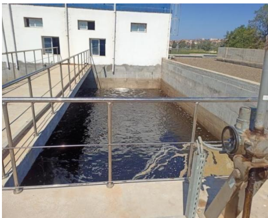
Figure II.7: Filtre à sable plein pendant le fonctionnement.
