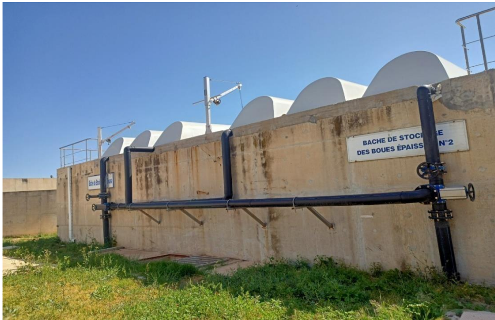
Figure II.11: Bâche de stockage des boues.
