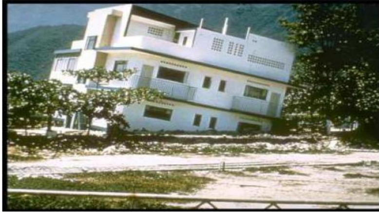
Figure 1.14. Liquéfaction des sols Séisme de Caracas, Venezuela 1967 [4].
