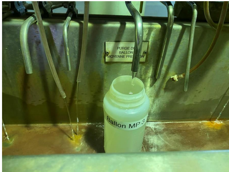
Figure II-6: prise d'échantillonnage du ballon MP3
