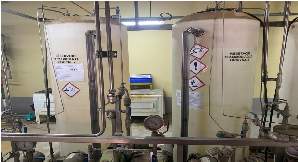
Figure I-23 : Réservoir d'injection du phosphate et ammoniacque du HRSG 2
