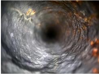
Figure I-18 : corrosion dans la chaudière
