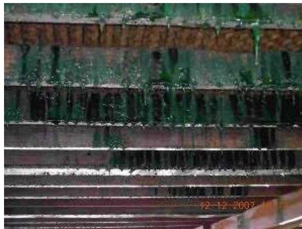
Figure II.9 – Prolifération d'algues dans la tour de refroidissement.
