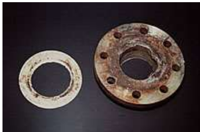
Figure II.10 – Corrosion caverneuse (sous joint) sur une bride en acier inoxydable exposée à un milieu riche en chlorures.
