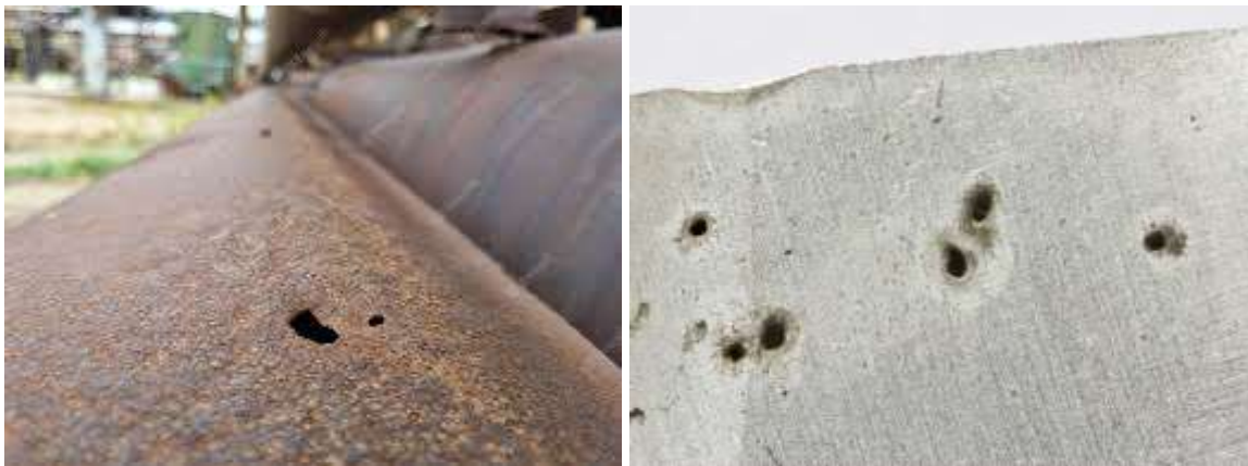
Figure II.3 – Corrosion par piqure.
