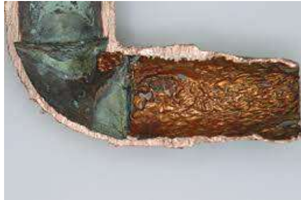
Figure II.6 – Corrosion-érosion d'un tube en cuivre véhiculant de l'eau.
