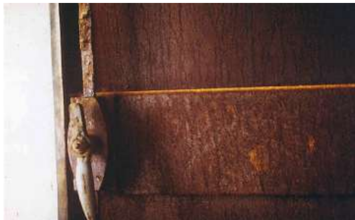
Figure II.1 – Corrosion uniforme d'une porte en acier inoxydable ferritique dans une atmosphère soufrée.
