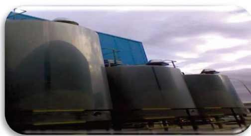
Figure 4 : les tanks pour stocké le lait cru .
