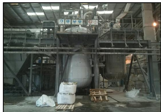
Figure .I. 6 : Unité de silicate de sodium
