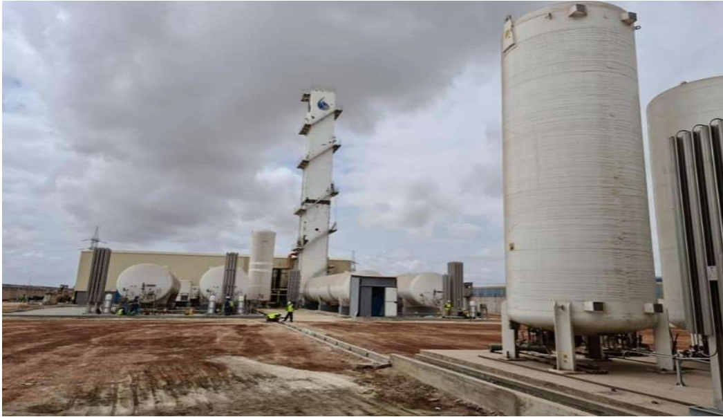
Figure II.1: unité de séparation d'air de Rayanox.
