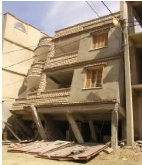
Figure I.3 : Destruction des extrémités des poteaux (Kebaili, 2009)
