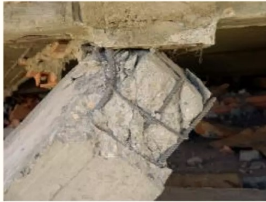
Figure I.2 : Insuffisance d'armatures transversales, béton de mauvaise qualité, rupture au droit de la surface de reprise (Kebaili, 2009)
