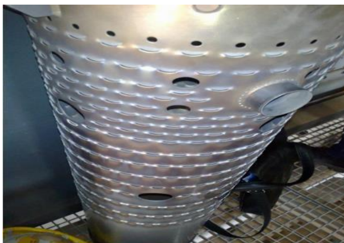
FIGURE I. 16: PHOTO DE LA CHEMISE DE CHAMBRE DE COMBUSTION (PRISE SUR SITE)
