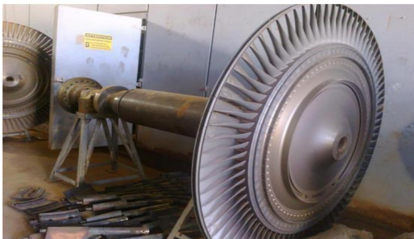
FIGURE I.22: VUE DU ROTOR DE LA TURBINE BASSE PRESSION (PRISE SUR SITE)
