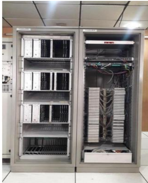
Figure 2.9 : Photo réelle d'équipement de VCCS tour de contrôle (Aéroport d'Alger)
