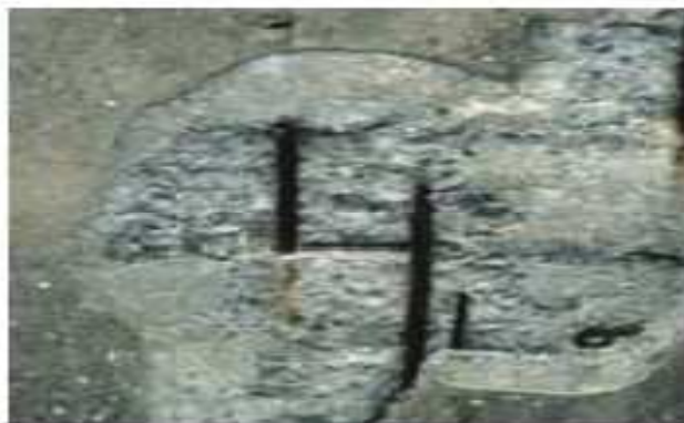
Figure II. 1. Eclatement du béton d'enrobage dû à la carbonatation. Château d'eau, [18].
