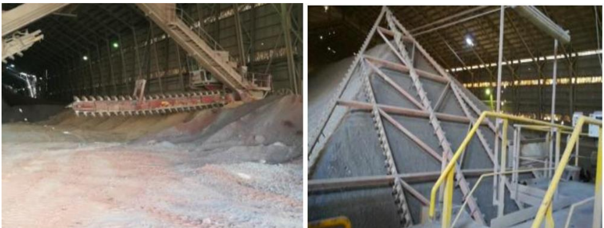
Figure I.2 : Reprise, transport et dosage des matières premières
