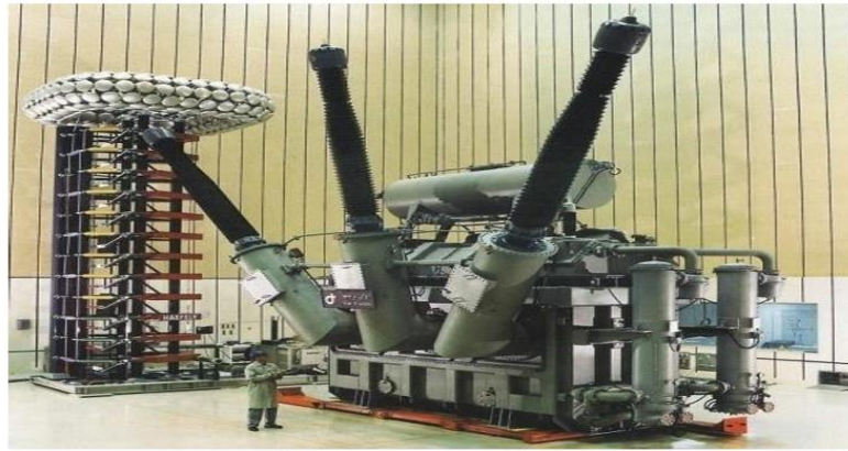
Figure I.2 Transformateur de puissance [6].
