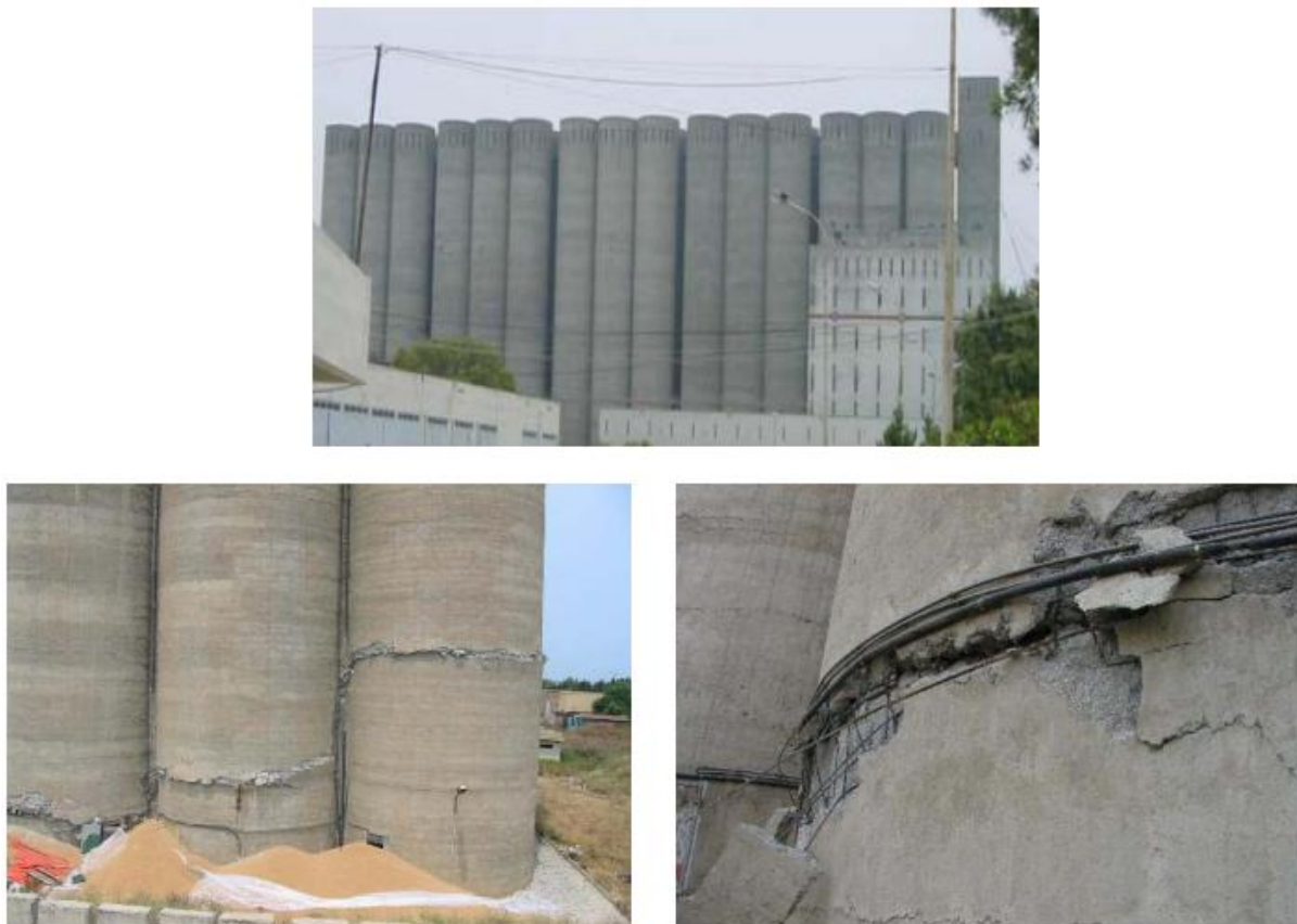
Figure V-2: Dommages observés sur les silos de grains de la société Eriad de Corso après le séisme de Boumerdes (2003).
