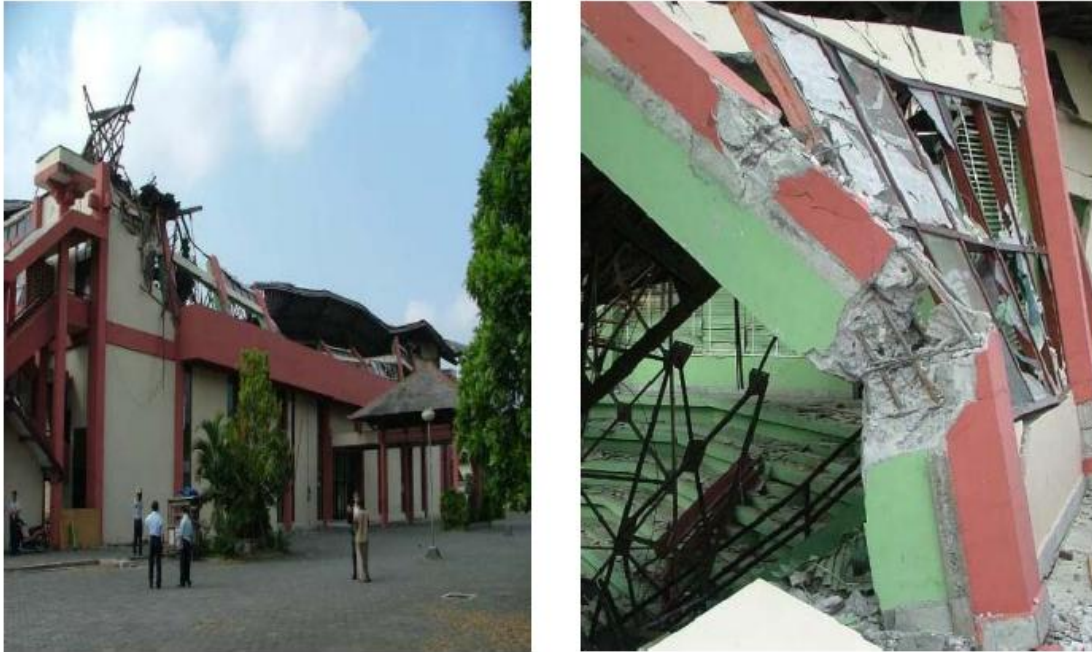
Figure V-3: Dommages du stade GOR Sport causés par le séisme de Yogyakarta (2006)
