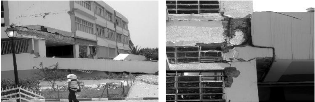
Figure I.18 : Effondrement de structure suite à une erreur de conception.
