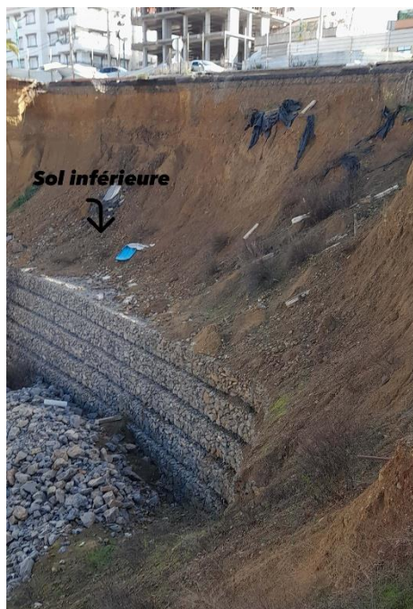
Figure 28: Situation de zone de glissement de sol inférieur.
