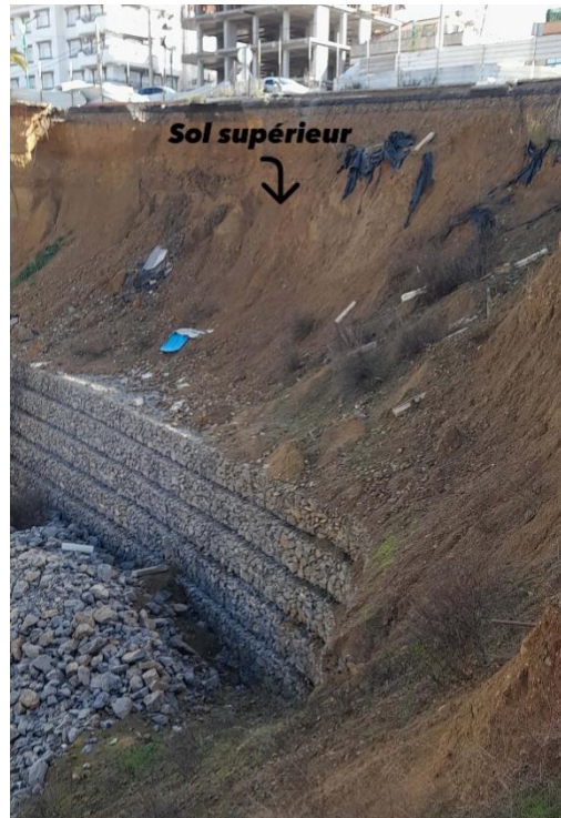
Figure 29: Situation de zone de glissement de sol supérieur.
