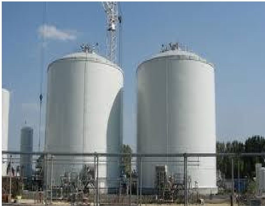
Figure III. 8 : réservoirs de stockage.
