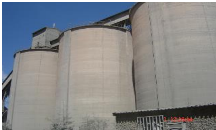
Fig.5.2-silo de stockage ciment
