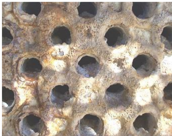
Figure II.8 État d'entartrage et de corrosion.
