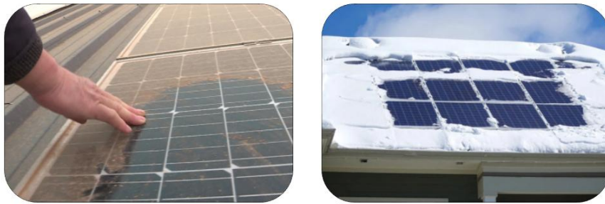
Figure II.2 : Défaut d'ombrage partiel dans un panneau photovoltaïque
