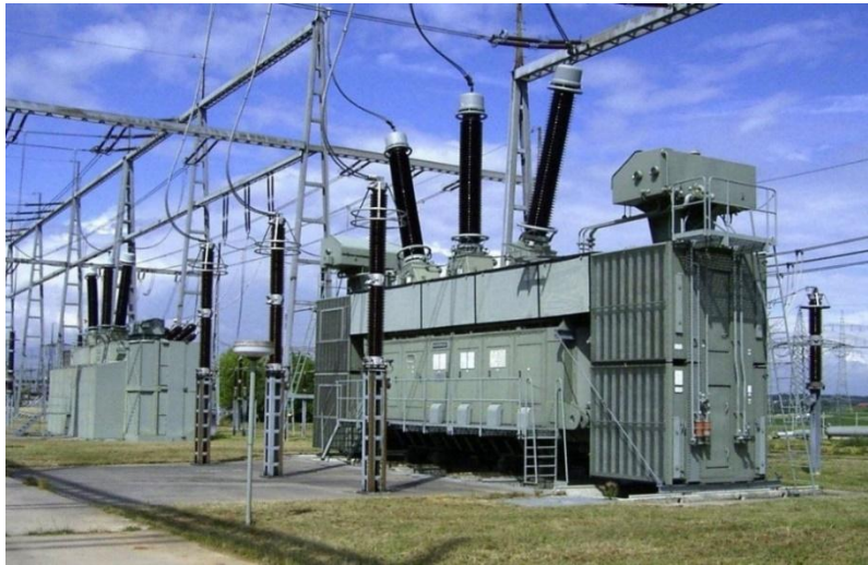
Figure I.8 : Transformateur de puissance.
