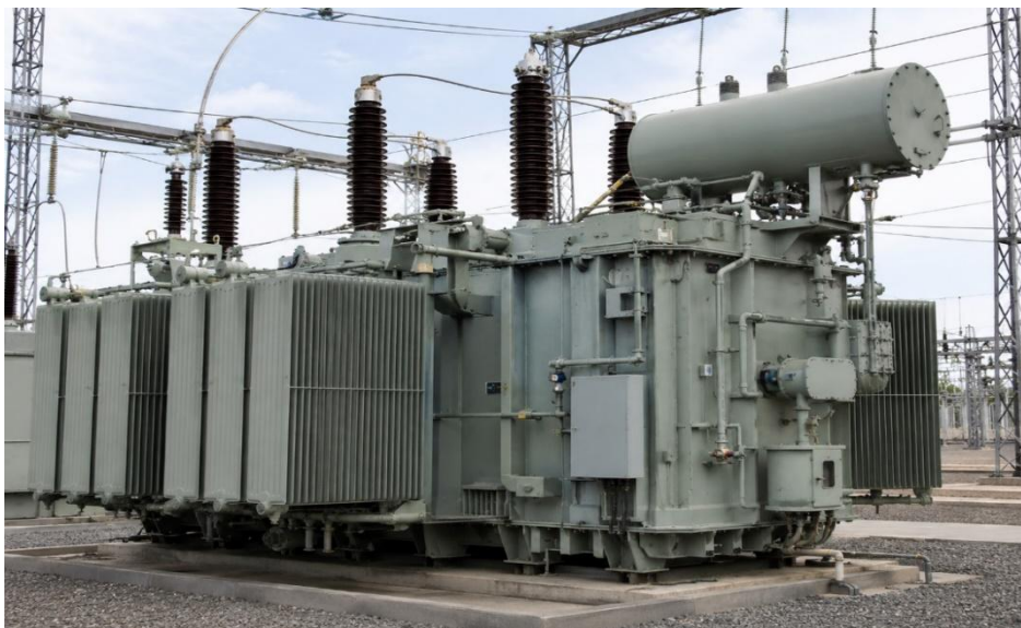
Figure I.12 : Transformateur d'interconnexion ou autotransformateur.
