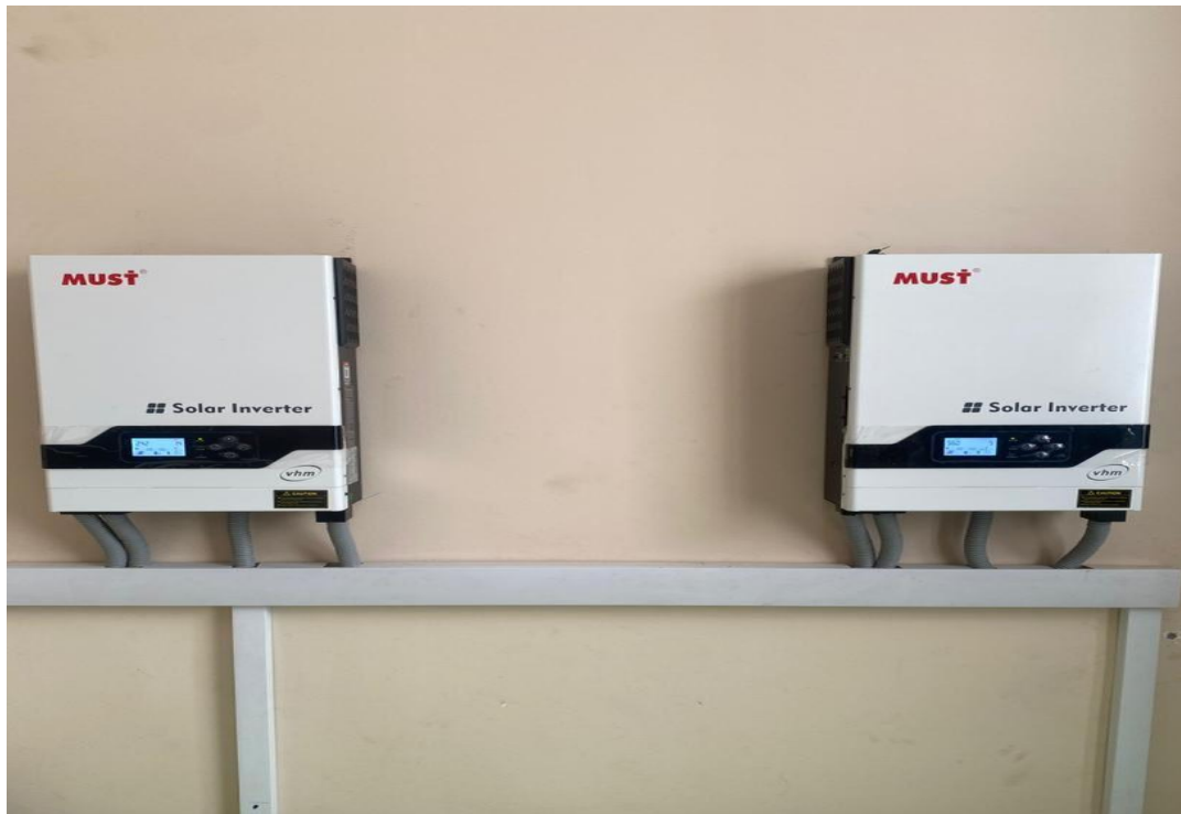
Figure 2.8: Les deux onduleurs hybrides PV1800
