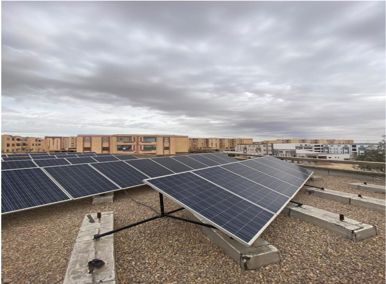
Figure 2.6: Installation du module PV dans le site d'étude
