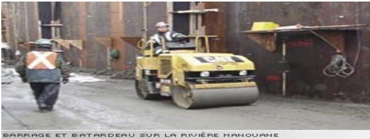
Figure I.11 : Barrage et Batardeau en BCR sur la rivière Manouane au Canada. [13]
